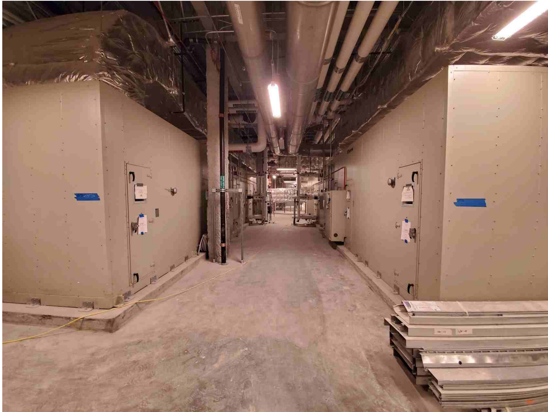
Infrastructure des services du 4e étage
